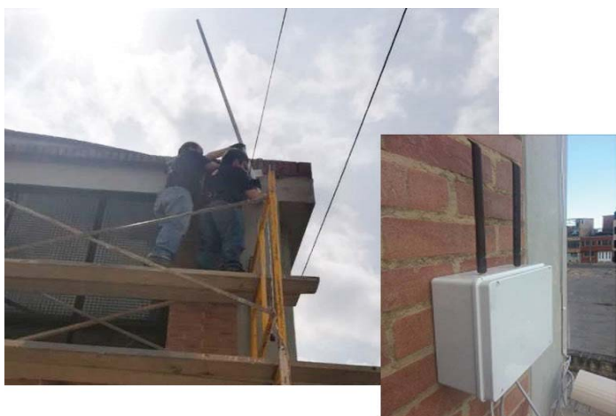
Figura 1. Izquierda: instalación de antena Nanostation M5 para enlaces troncales. Derecha: enrutador para redes en malla y punto de acceso. Fuente: Elaboración propia.
